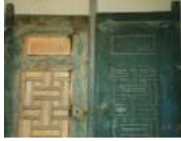
Resim 1.1: Yüzeyi temizlenmiş ahşap kapı ile yüzeyi temizlenmemiş ahşap kapı
